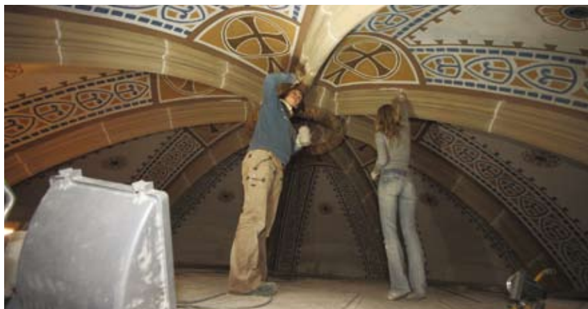
Arbeitsplatz Kirchenkuppel: Die Arbeitsplattform über dem Kirchenboden machte es möglich, dass die Restauratoren der alten Wandmalerei zu neuem Glanz verholfen haben.
